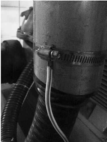
图为规范安装的 PE 线,参观区域全部规范安装。
