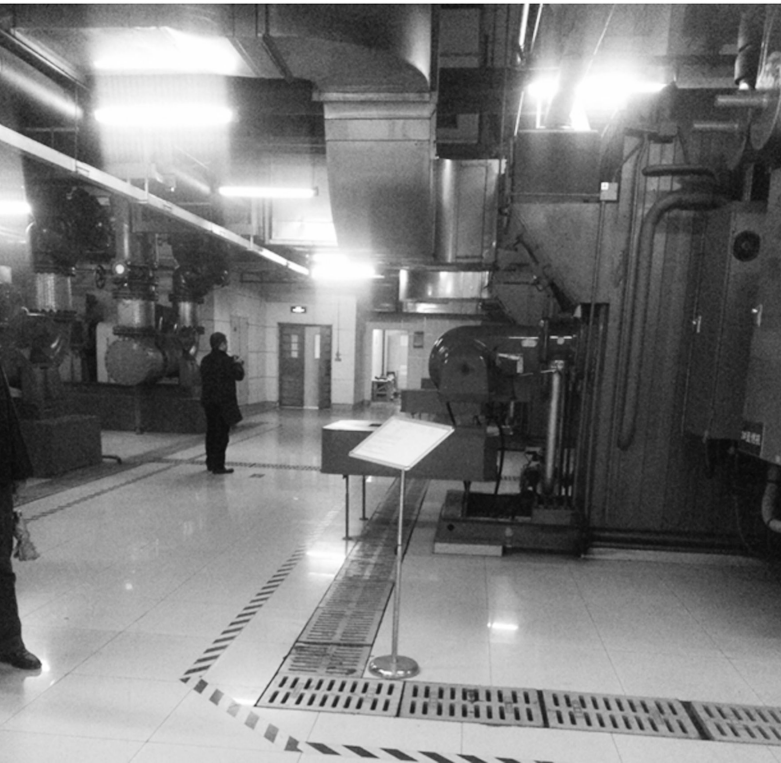
图为湘雅医院机房内景
