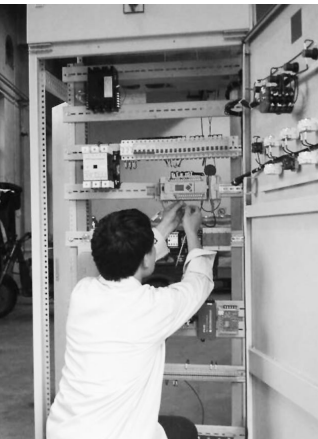
图为工作人员正在检查配电柜
